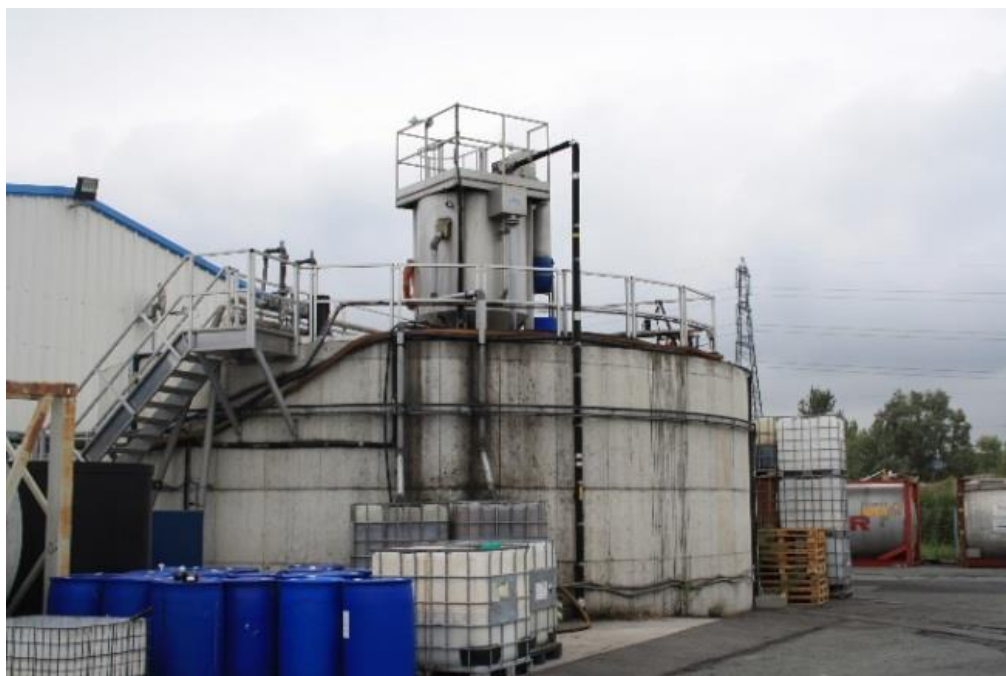
Station de traitement des eaux
