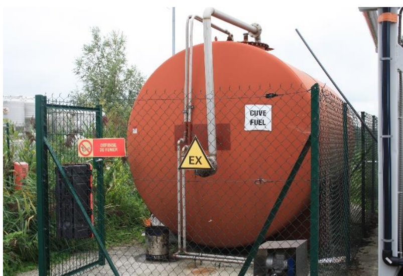
Cuve à fuel de 20 m 3
