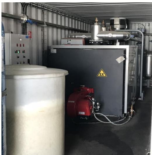
Chaudière n° 1 ( fuel )
