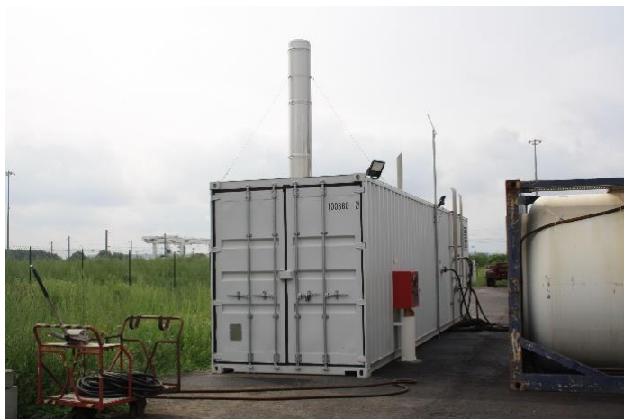
Local conteneur de la chaudière n°2 ( gaz)
